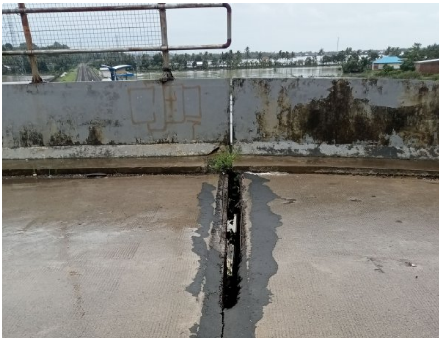
Sambungan jalan fly over Pekkae rusak parah
